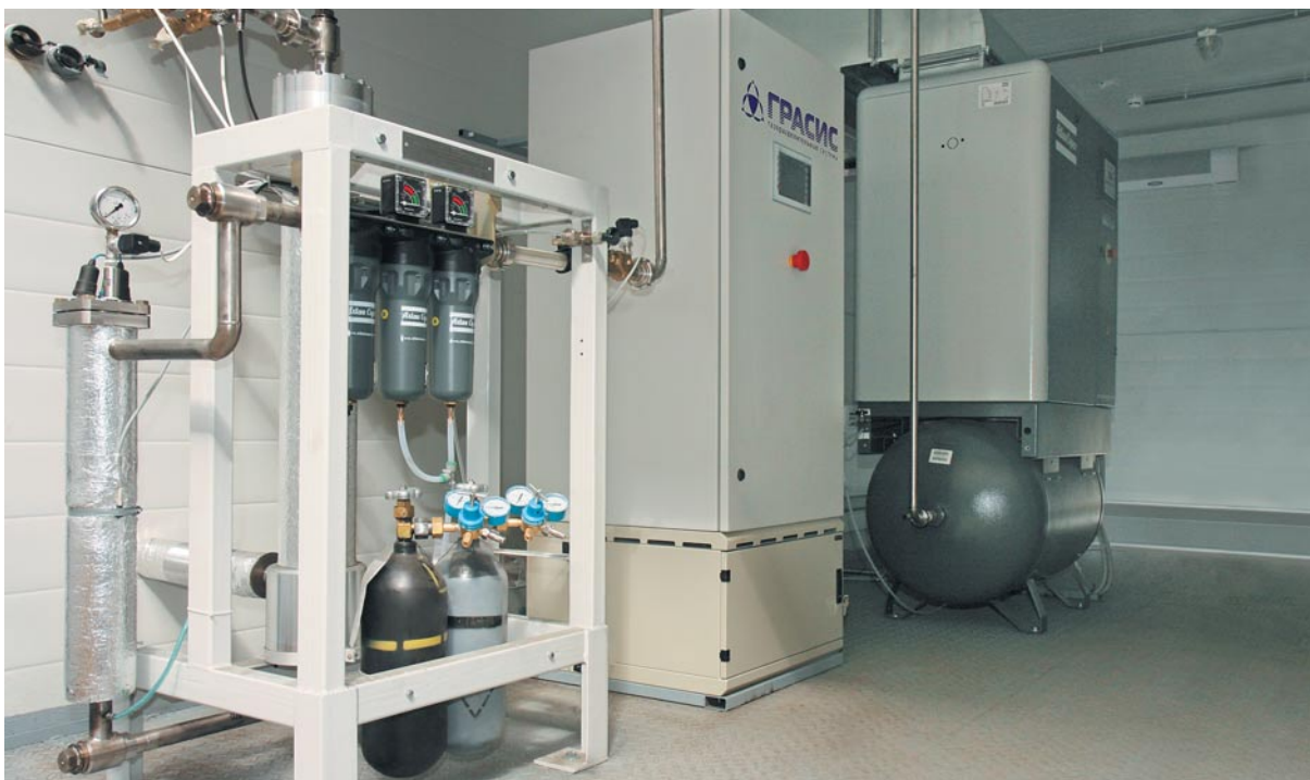
Установка азотного пожаротушения
